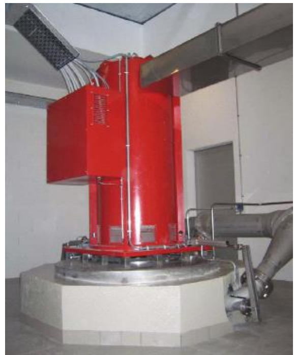
Groupe turbo-générateur installé (465 kW)
