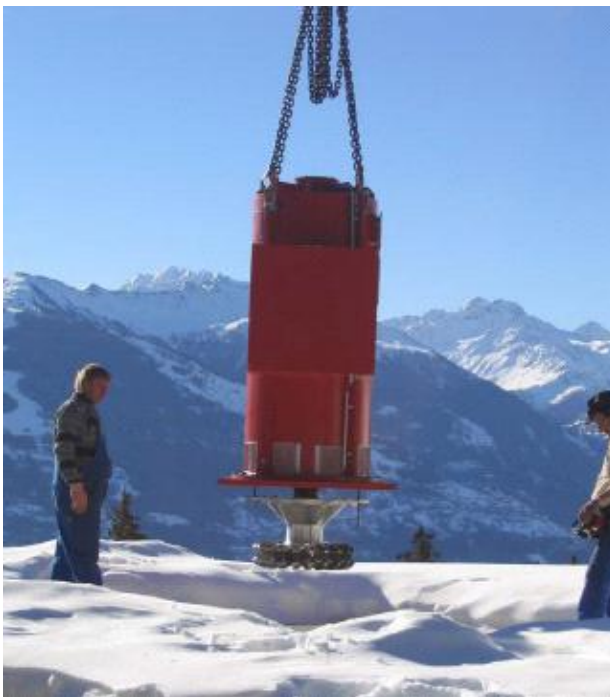
Mise en place de l'alternateur et de la roue de la turbine Pelton
