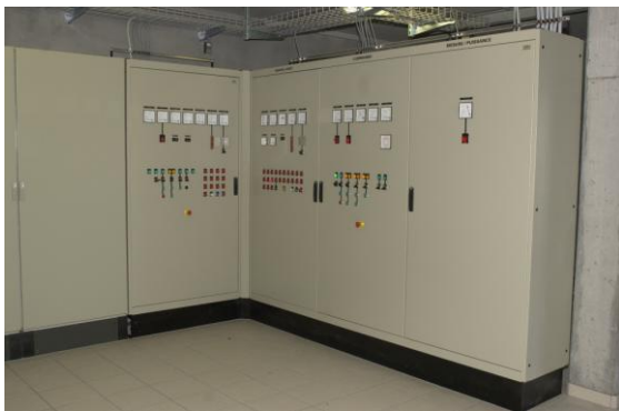
Ollon II & III : Armoires électriques des turbines
