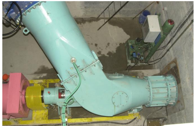
Arrivée d'eau et groupe turbo-générateur de 348 kW
