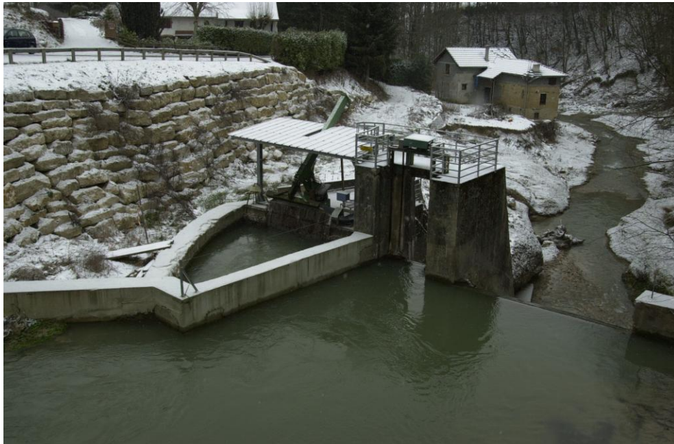
Prise d'eau de la centrale
