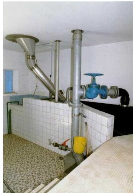
Vue de l'arrivée de l'eau dans le réservoir
