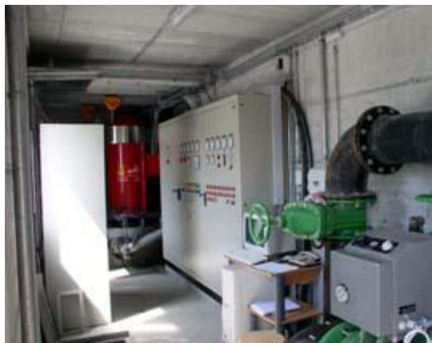
Intérieur du local de turbinage (source: commune de Savièse)
